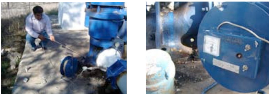
FIGURE 14 : Mesure du niveau dynamique du bassin d'aspiration de pompage
